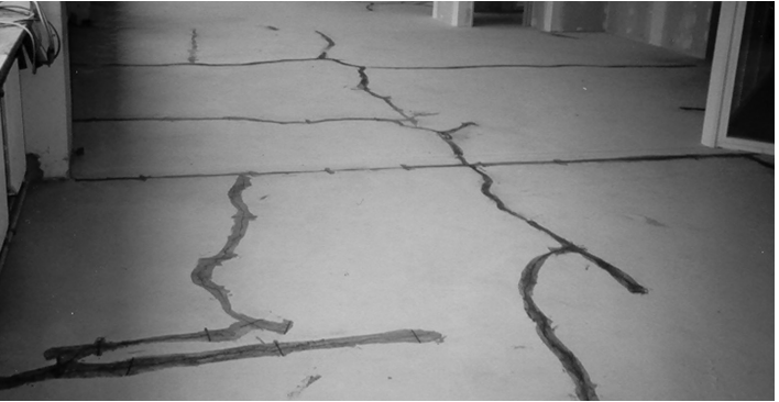
Abbildung: Rissbildung durch intensive Schwindung eines Estrichs Quelle: FUSSBODEN ATLAS®
